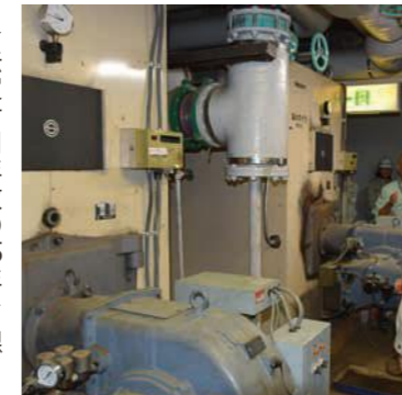
▶法定耐用年数の15年を過ぎ劣化が進むボイラー
