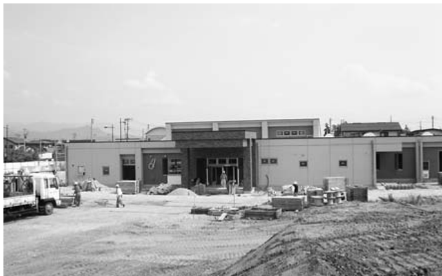
防災センター
