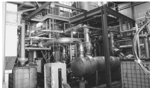
木質バイオマス発電設備やまがたグリーンパワー(村山市)
