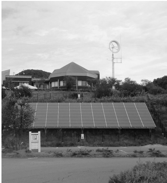
太陽光・風力発電施設
