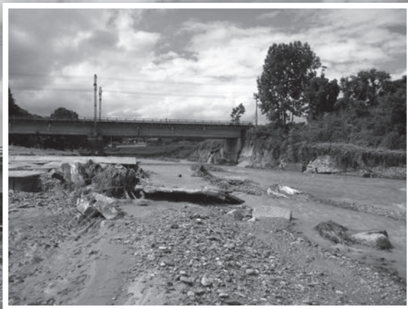
三間通地内長岡堰護床流失
